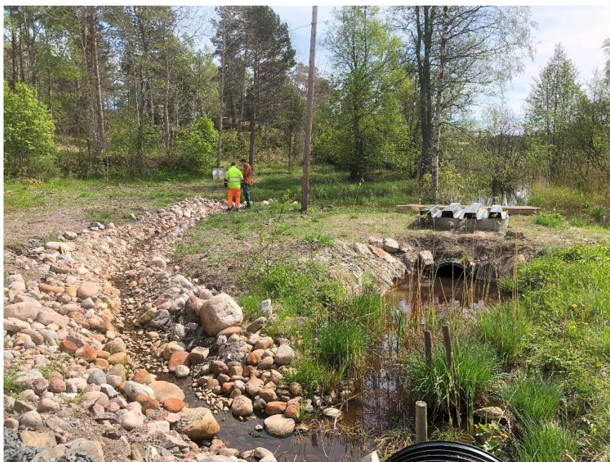
Figur 6. Ex. på omlöp för fisk, intill en plugg i utfallsdiket, där en munk sitter installerad.
